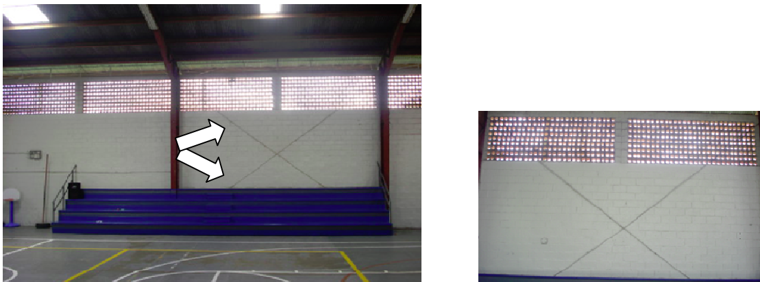
Figura 9: Pared del gimnasio sobre el cual trata el problema P1
